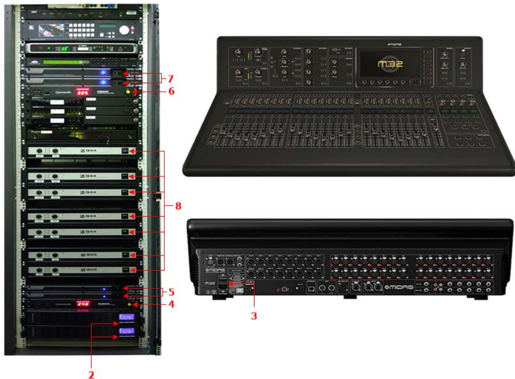
ภาพที่ 4 แสดงลำดับการเปิดระบบควบคุมเสียงภายในห้องประชุมเทวกุล
