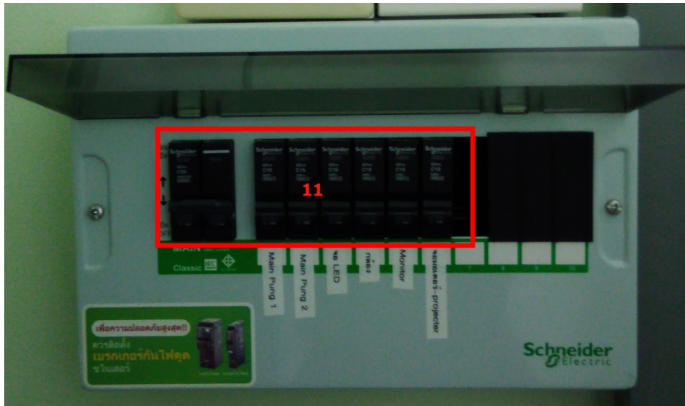
ภาพที่ 16 แสดงการปิดเบรกเกอร์ควบคุมระบบเครื่องเสียงห้องประชุม
